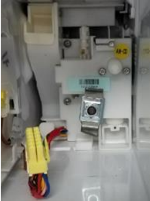
Auger Fan OK
